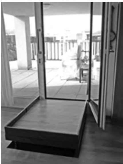
Terrasse accessible aux fauteuils roulants par l'élévateur «Stepless»
